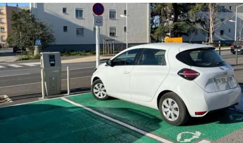
Borne électrique Saint-Martin-de-Crau
