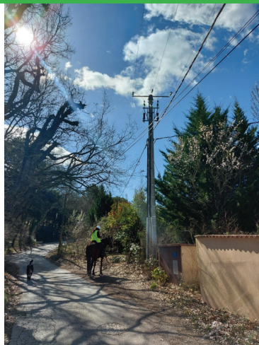
Sur la commune de Trets, une surveillance du réseau à cheval pour identifier les tronçons prioritaires.
